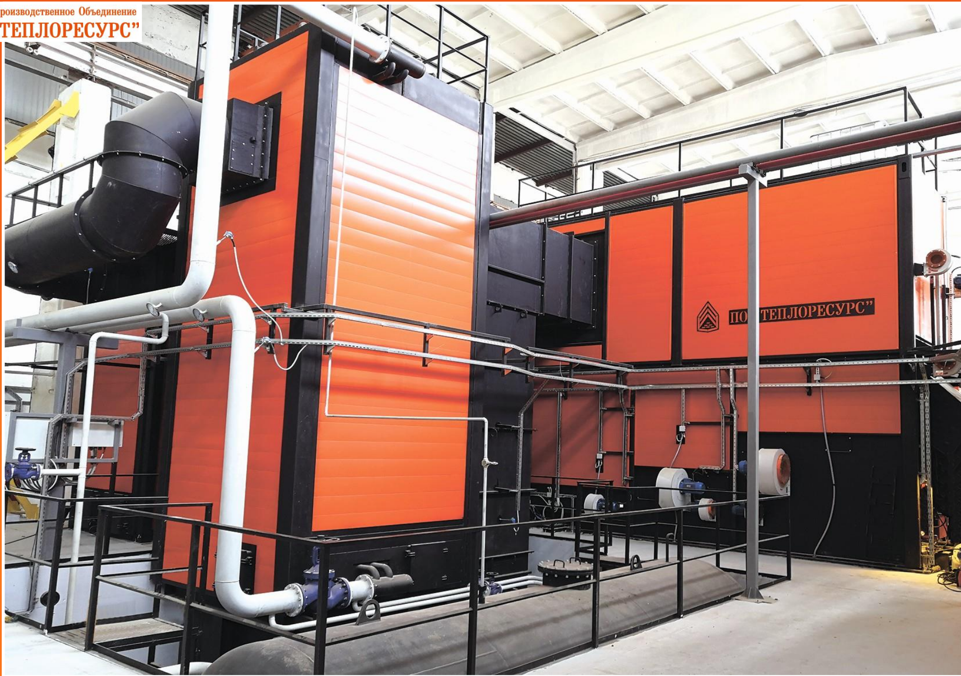
Термомасляная котельная 5 МВт
